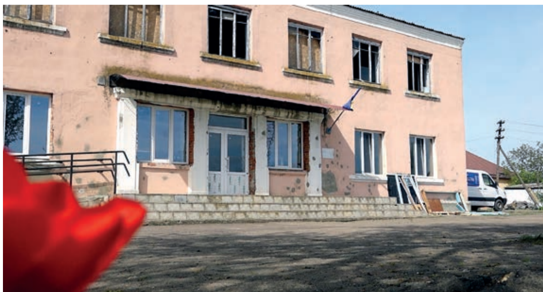
ODNOWIENIE ZNISZCZONEGO PODCZAS OSTRZAŁU AMBULATORIUM
