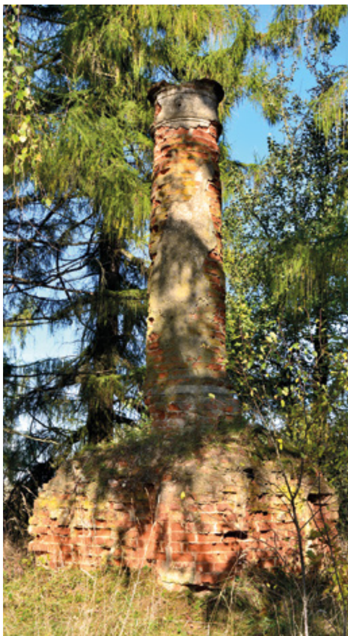
Stan kolumny przed renowacją
