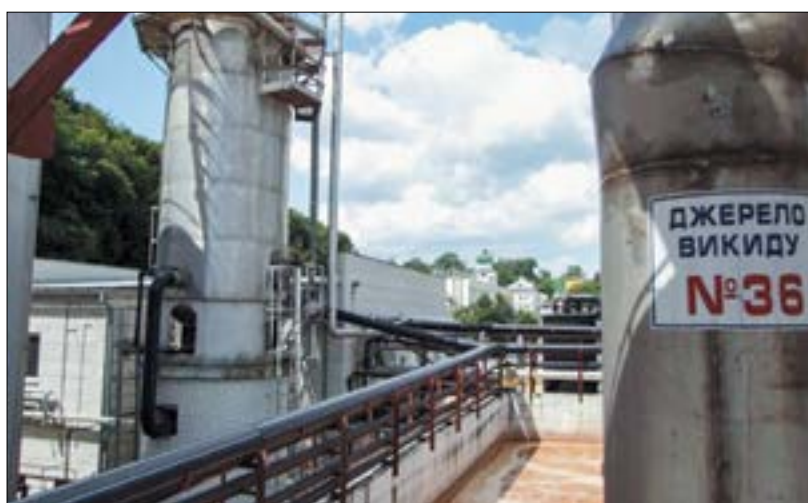
Oczyszczalnia ścieków we Lwowie
