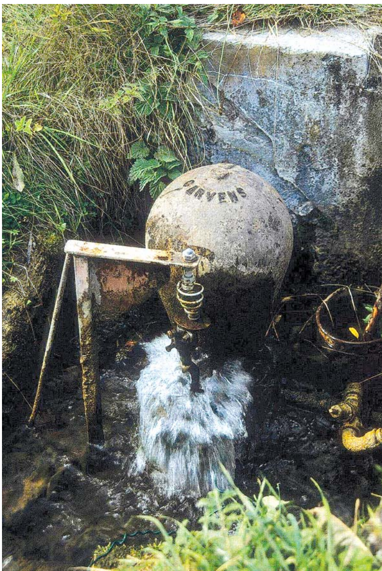
Widać wodę, tryskającą spod właśnie otwartego zaworu C
